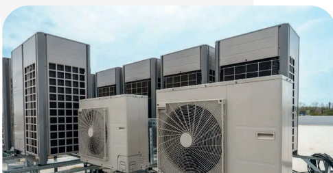
Sistemas de Ventilación
